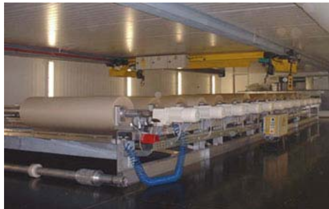
Sala con depósito de bobinas PVB en el segundo piso
